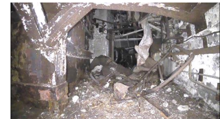
原子炉建屋通路(3FL)
