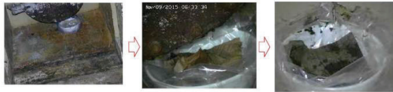
11/4の作業終了後、フランジ下部、にじみのある場所にウエスを入れた受け皿を設置。 11/6作業開始前に受け皿内を目視確認。表面線量測定実施。 11/6.7も作業終了後ウエスと受け皿を設置。 11/8作業開始前に受け皿内を再度目視確認
