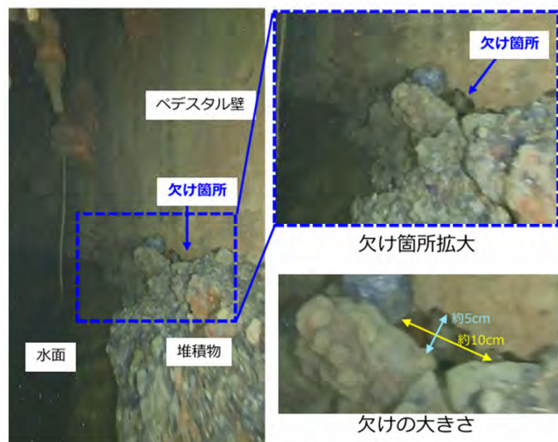
ペDESTAL壁の欠け箇所
