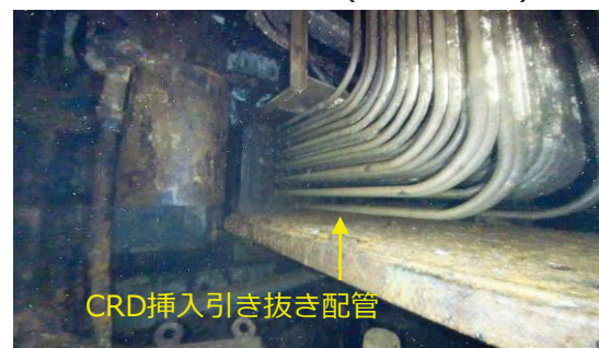
②：CRD挿入引き抜き配管(北東)
