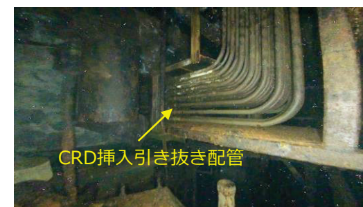
③：CRD挿入引き抜き配管(南西)
