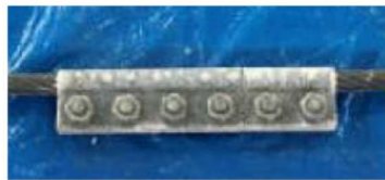
劣化 1 年相当 白錆を確認
