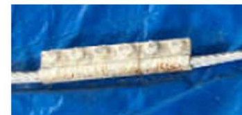
劣化 6 年相当 赤錆を確認
