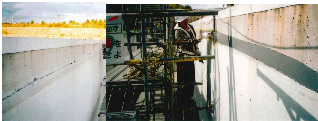
図 4 覆い側部のひび割れ状況(左)と保修(右)
