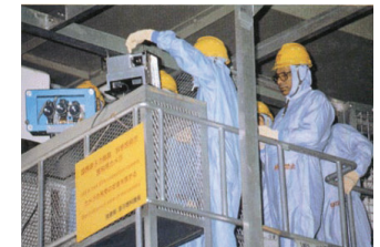
監視装置の保守管理
