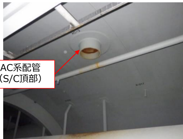
（参考）5号機AC系配管のS/C突き出し状況
